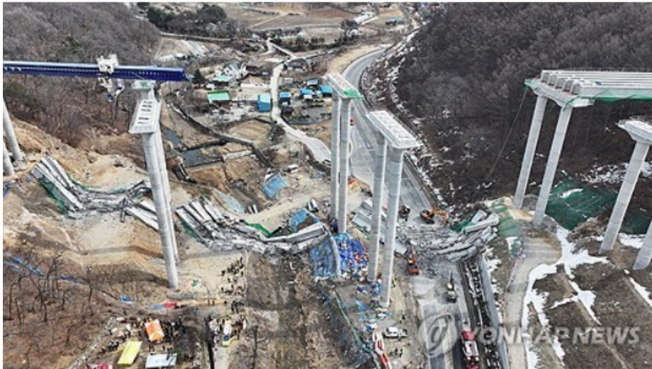
[사진 1] 서울-세종 고속도로 거더(Girder) 붕괴사고
