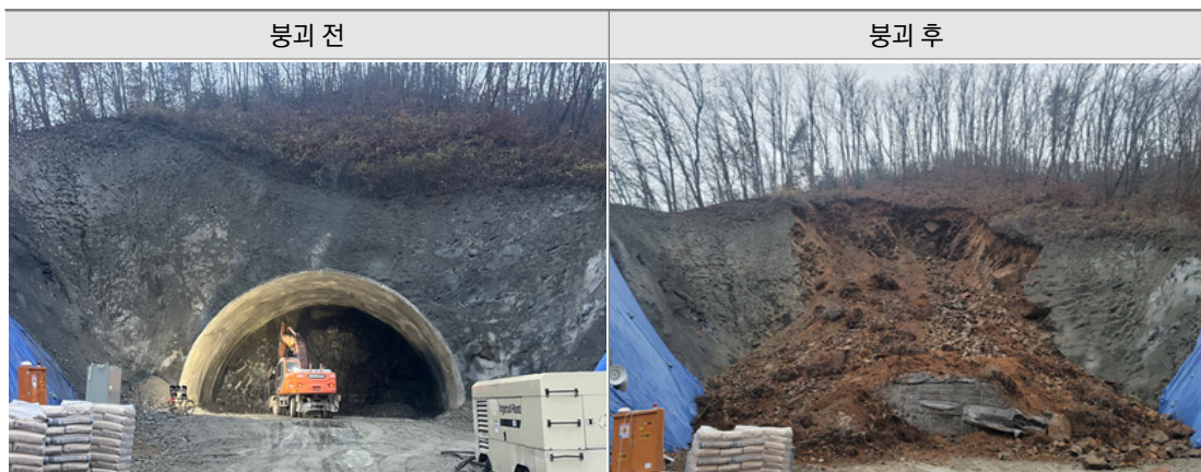
[사진 7] 터널 붕괴 사진
